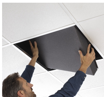
Después de retirar la losa inicial, inserción completa de la losa AirPanel en el techo
